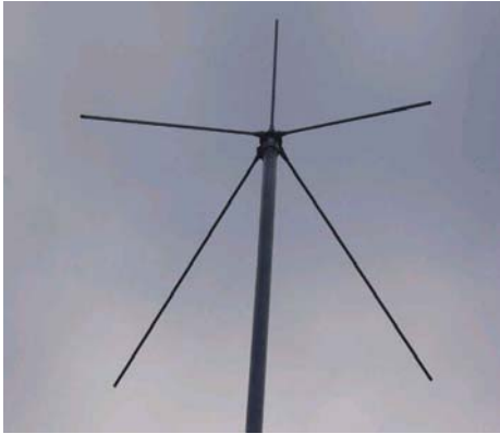
19 Antennenkopf mit Dipol und Gegengewichtsstäben
