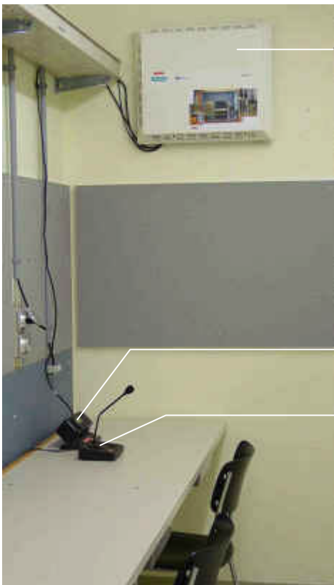
Fixstation an der Wand montiert
